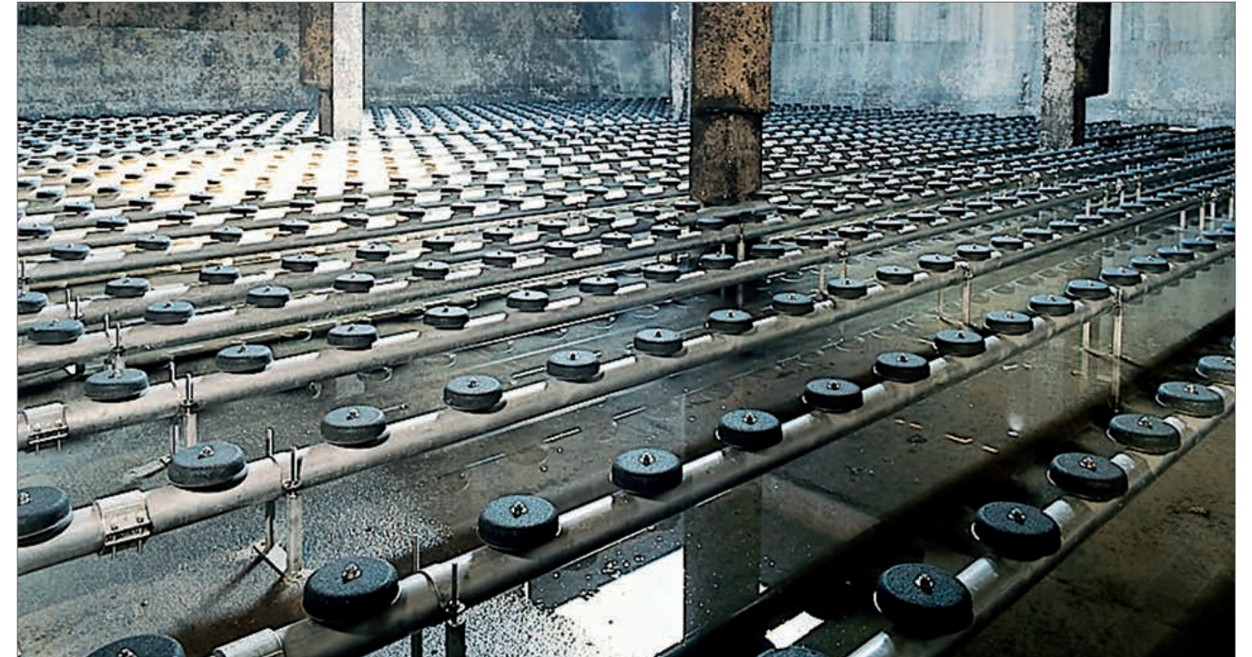
Belüftungsdome am Beckengrund
