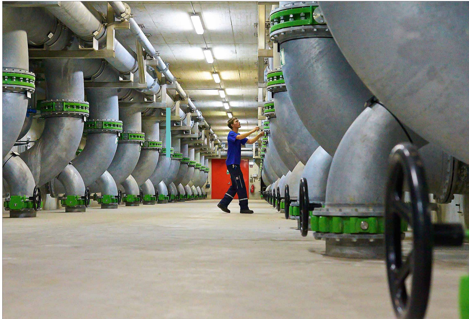
Rohrkanal unter der Flockungsfiltration
